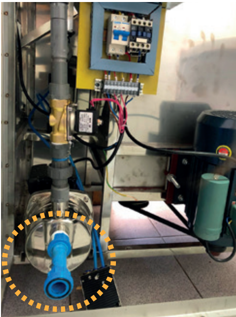
Fig. 5 Instalación de tubería en la entrada de bomba de agua que conectará la lavadora con el estanque de agua producto.
