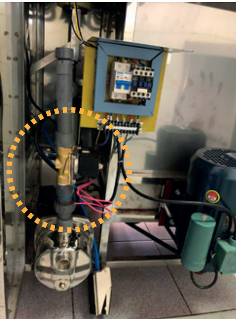
Fig.3 Válvula solenoide instalada en tubería de agua producto de lavadora.
